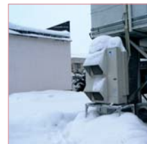
Пример эксплуатации наружного блока
