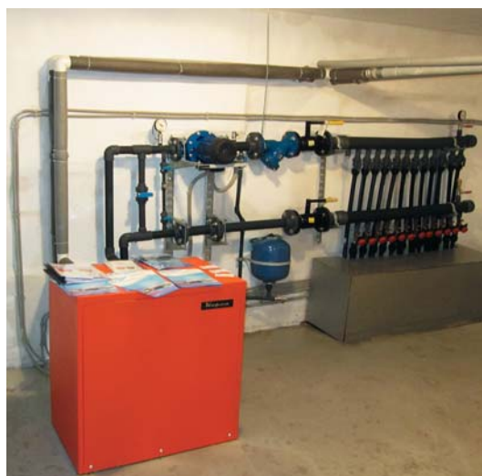
ТНУ «Корса» в энергоэффективном доме в г. Кондрово
